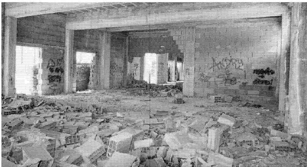
Vandalismo distruttivo nell'edificio abbandonato ex Sea Flight, a ridosso della Punta (foto Enrico Di Giacomo)
